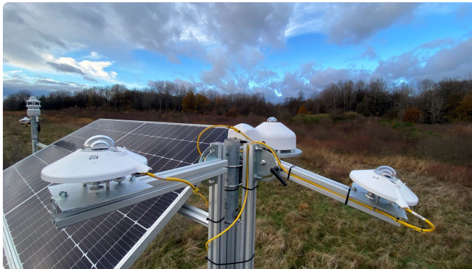
Station de mesure autonome sur site. Irradiation en plusieurs orientations, température, humidité et variables microclimatiques, enregistrées toutes les cinq minutes.
