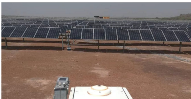
Station de mesure et champ PV à Loulo. Les caméras fisheye hémisphériques placées autour de la centrale captent les formations nuageuses que l'imagerie satellite et les capteurs d'irradiance ne résolvent pas.
