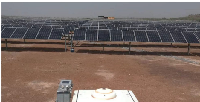
卢卢的测量站与光伏场区。布置在电站周边的半球鱼眼相机可捕捉卫星图像和辐照传感器无法分辨的云团。
